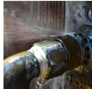
图 8: 管道老旧渗漏 [10]
