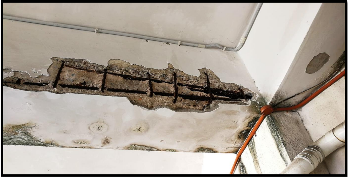
图 2: 水分入侵导致梁上混凝土剥落
