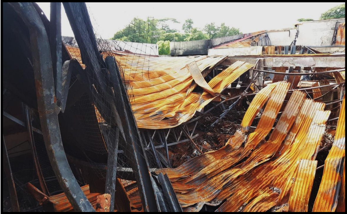
图 2：高温下钢屋架的损坏
