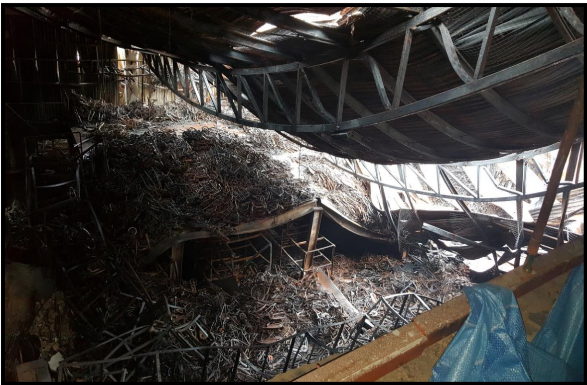
图 3：高温下的钢屋架和平台损坏
