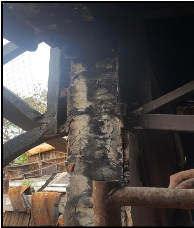
图 5: 拆除方墙后发现结构性裂缝在混凝土柱上
