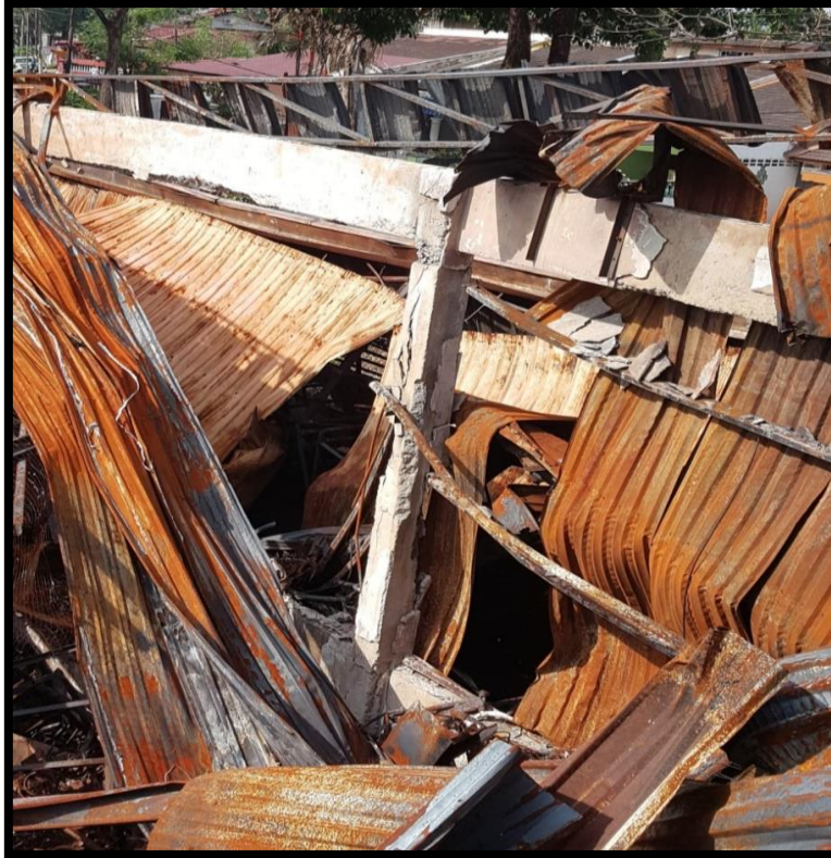
图 4: 高温下柱上的混凝土剥落
