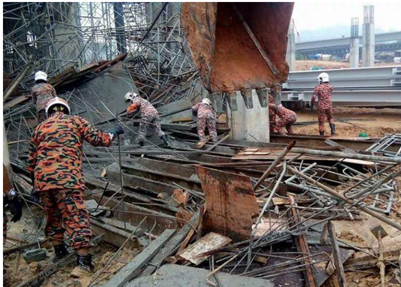
图 7: 失败的临时工程 (支架) [13]
