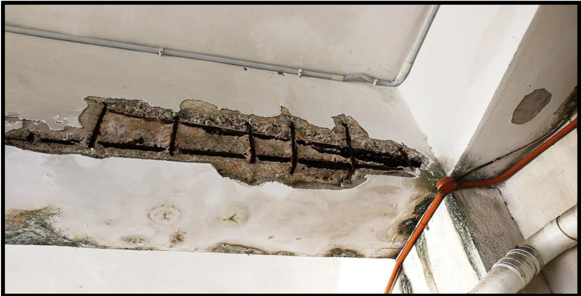
Gambar 2: Konkrit Spalling Di Atas Rasuk Disebabkan Penyerapan Kelembapan
