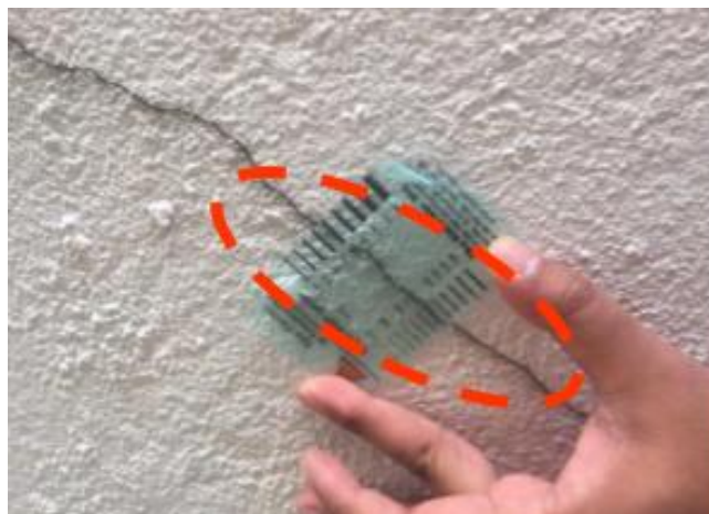
Gambar 1: Pengukuran retak menggunakan pembaris ukur retak
