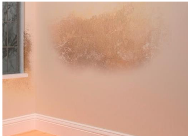
Gambar 2: Kelembapan di dinding
