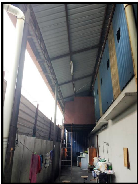
Rajah 1: Penyambungan yang tidak dibenarkan
