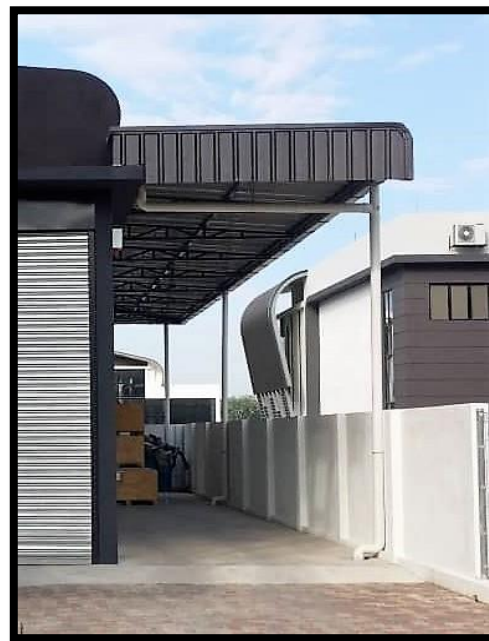
Rajah 2: Penyambungan yang tidak dibenarkan
