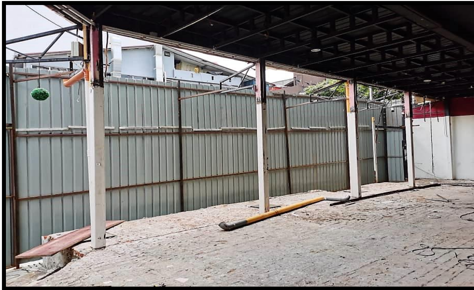
Rajah 3: Penyambungan yang tidak dibenarkan
