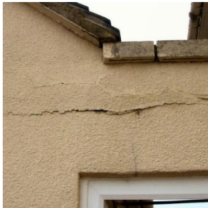
Rajah 5: Retakan pada dinding [7]
